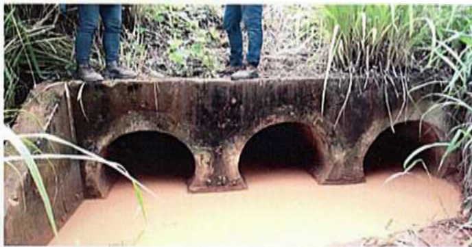
Figura 4 - Tubulações clandestinas nas margens do Rio Cateté, apontadas no sentido do rio.
